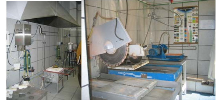
Ejemplo de instalaciones ruidosas en el CSIC:
